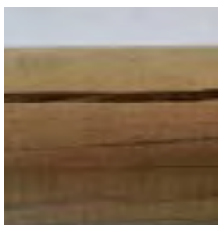
Cracks/Grietas/Fente/Risse/ Crepe/ Barsten/Fendas
